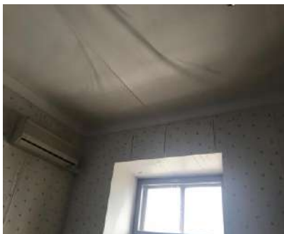
Фото 16. Разрушение подвесного потолка.
