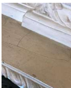
Фото 14. Разрушение декоративной штукатурки.
