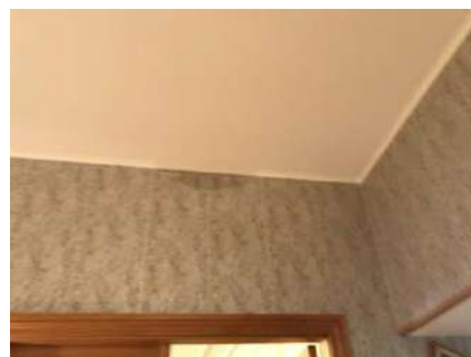
Фото 4 – нарушение свойств подвесного потолка в прихожей
