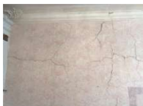
Фото 18. Разрушение декоративной штукатурки
