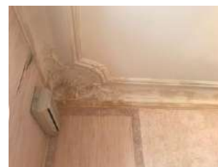
Фото 20 – разрушение лепнины на фризе
