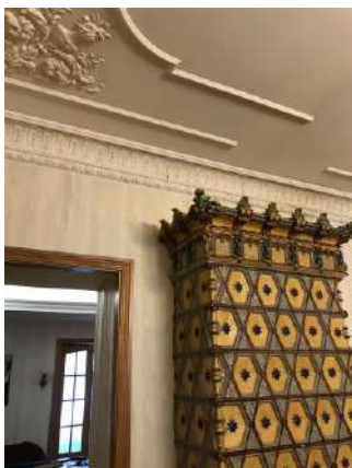
Фото 9 – отслоение лепнины на потолке
