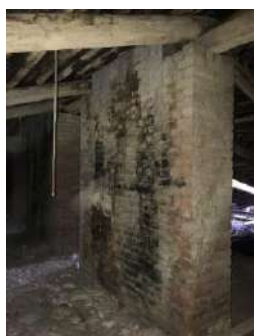
Фото 26 – разру- шение кладки
