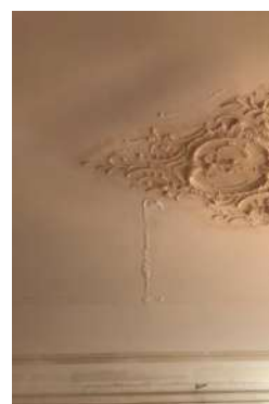
Фото.22 – разрушение лепнины на декоративном лепном плафоне
