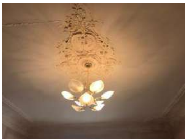
Фото 6 – разрушение декоративного потолка с лепниной
