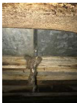
Фото 27 – сквоз- ные отверстия в кровельном по- крытии
