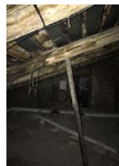
Фото 28 – разру- шение обрешетки
