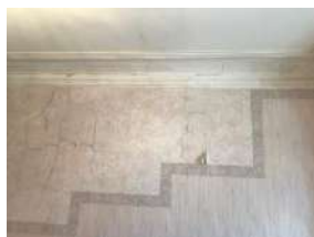
Фото 19 – отслоение обоев в местах протечки
