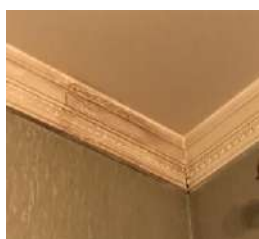
Фото 13. Отслоение лепного фриза.
